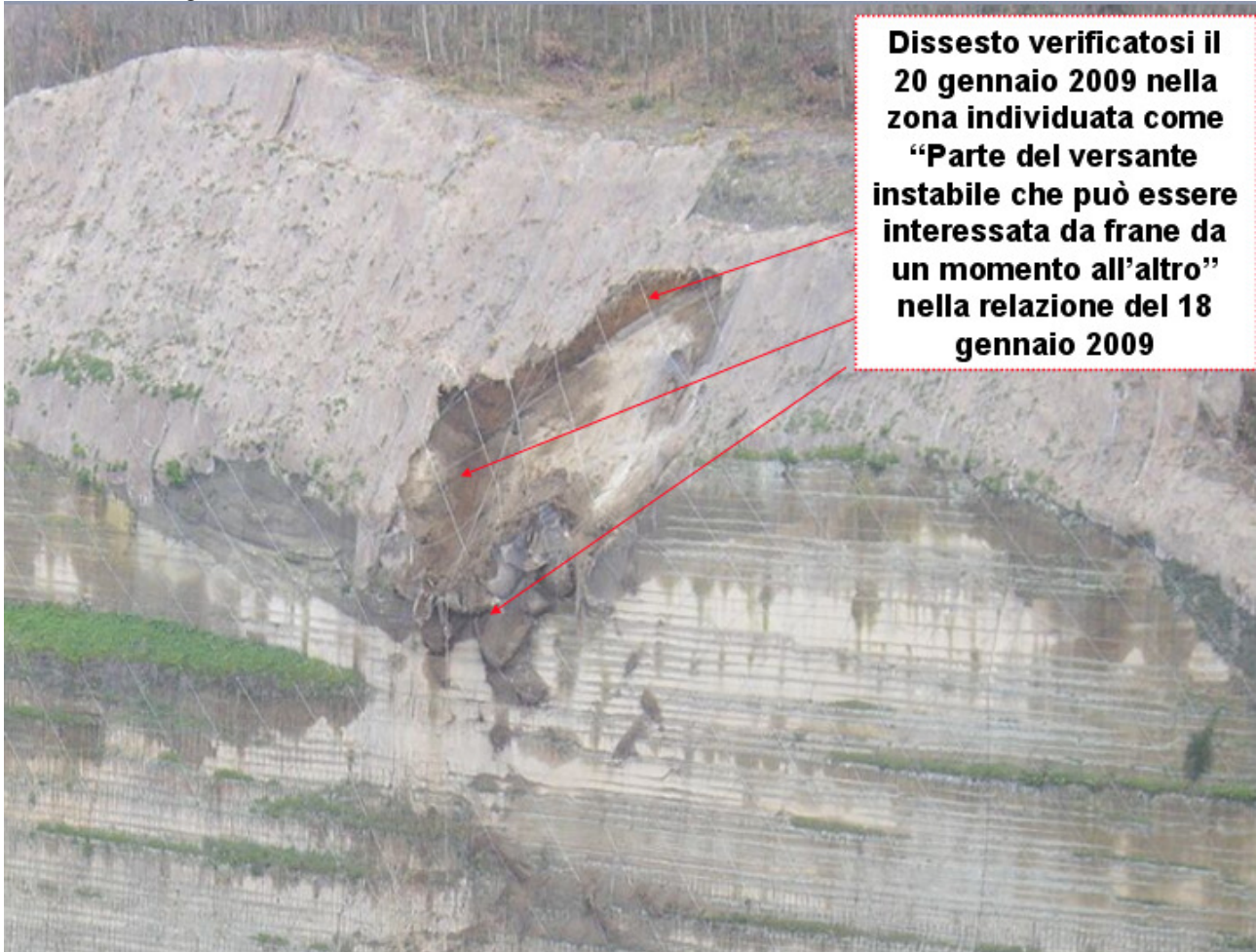
Figura 1: dissesto verificatosi il 20 gennaio 2009
